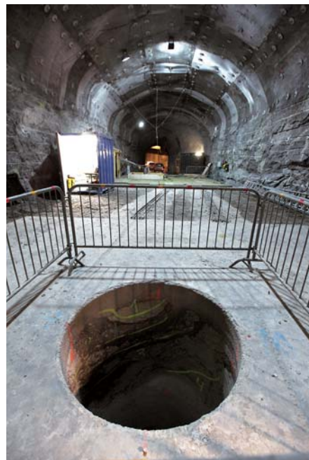
オルキオトの地下特性調査施設内の坑道と試験処分孔 （写真提供：ポシヴァ社）
