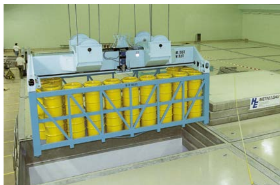
中レベル放射性廃棄物の貯蔵建屋（左図の 3）
