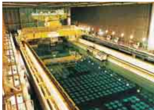
酸化物燃料再処理プラント（THORP）内の 使用済燃料貯蔵プール (写真提供：NDA)
