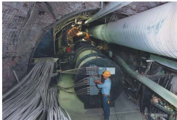
探査研究施設 (ESF) でのヒーターテストの様子 (DOEウェブサイトより引用)
