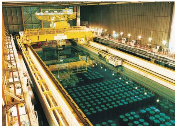
酸化燃料再処理プラント（THORP）内の 使用済燃料貯蔵プール (セラフィールド社ウェブサイトより引用)
